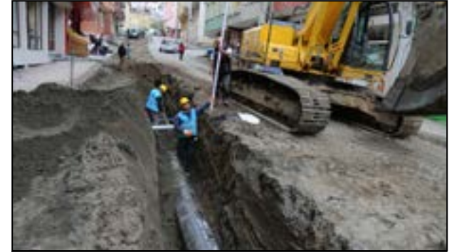
Telekom Altyapı Tesisi
