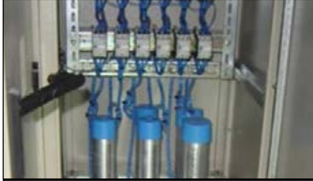
Alçak Gerilim Kompanzasyon Tesisi
