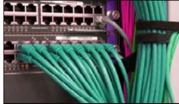
Telefon Dağıtım Sistemleri
