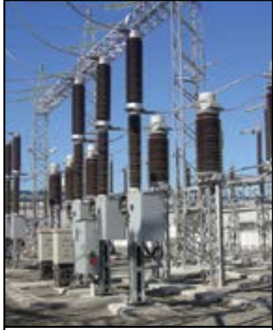
154kV Enerji Nakil Hattı
