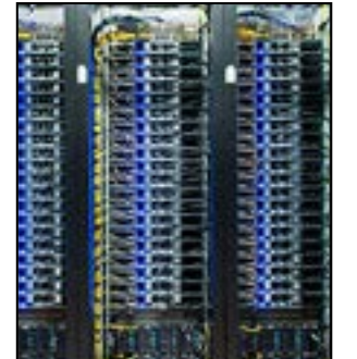
Data Merkezi ve Data Tesisatı
