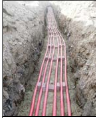
Yüksek Gerilim Kablo Tesisleri
