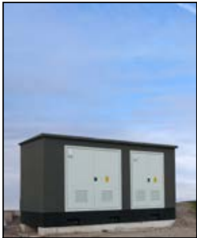
Monoblok Elektrik Tesis
