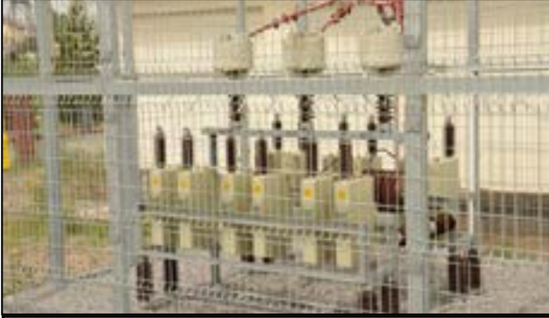
Orta Gerilim Kompanzasyon Tesisi
