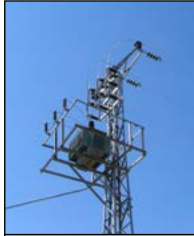
36/0,4 kV Direk Tipi Trafo
