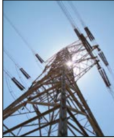
6,3 - 15 - 36kV Enerji Nakil Hattı
