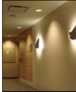
Bina İç Tesisat Tesisleri
